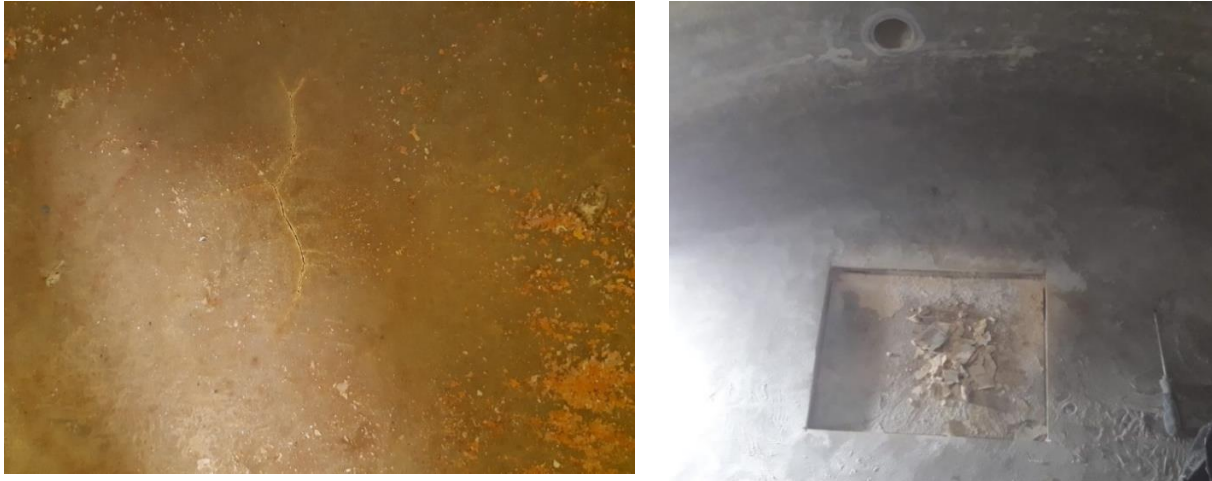
Fissure au fond de la cuve et présence de cailloux
